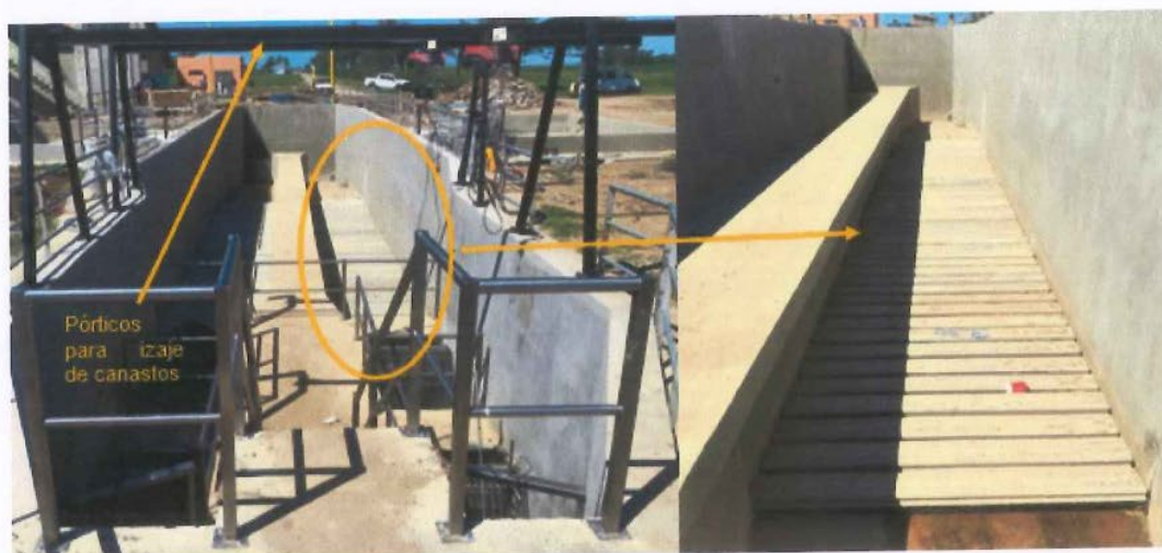
Imagen 3: canales de rejillas y desarenado
