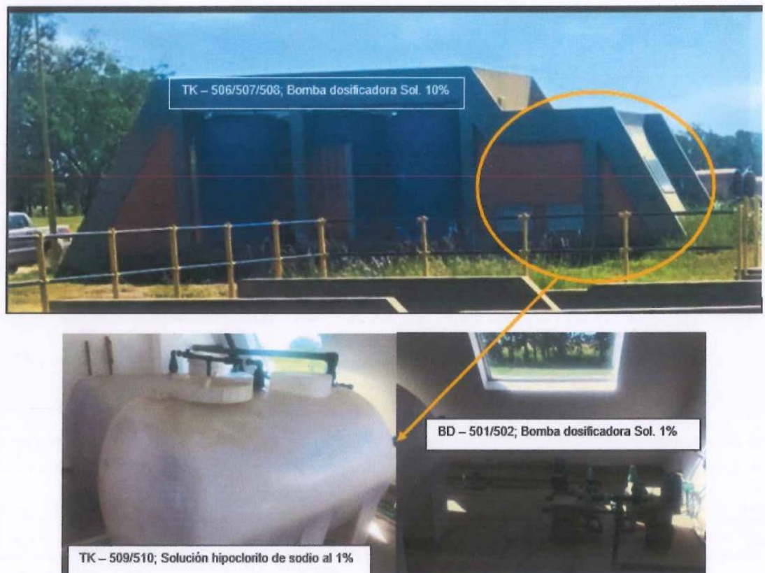
Imagen 19: Almacenamiento y dosificación de hipoclorito de sodio
