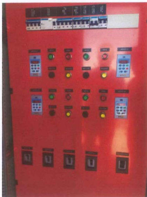
Imagen 12: Tablero local de aireadores ubicado sobre talud de entrada a lagunas facultativas aireadas
